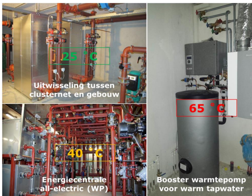
Figuur 28 - Foto's van de elementen van een energiecentrale in een groot gebouw (utiliteit)
