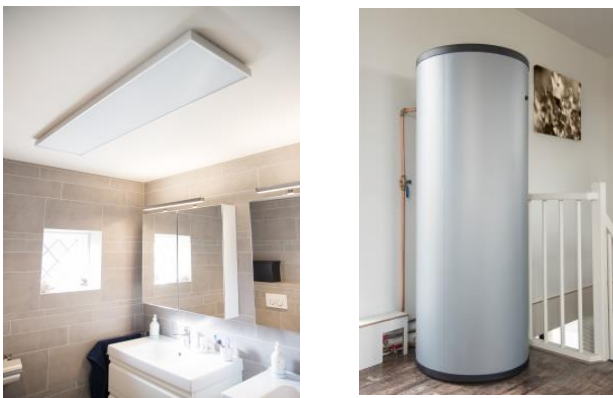
Figuur 22: IR-paneel in badkamer + 300 liter boiler voor warmtapwater
