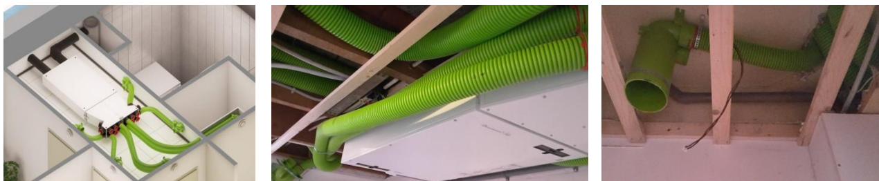
Figuur 39: Centrale ventilatie-unit aan plafond met leidingwerk (bron: Brink Climate Systems)
