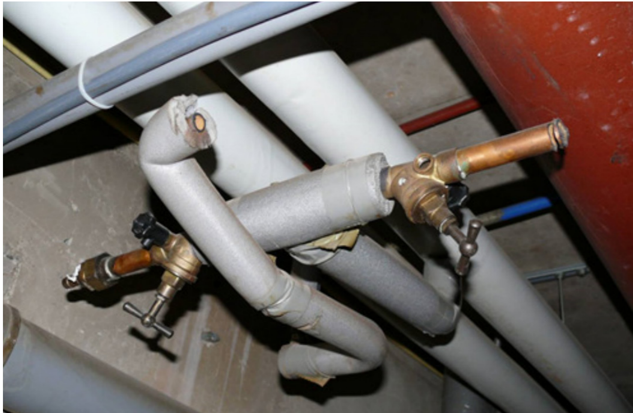
Voorbeeld van een drinkwaterinstallatie met dode leidingen. Bron: Van Hofweegen, KWA Bedrijfsadviseurs (2016) ⁹.
