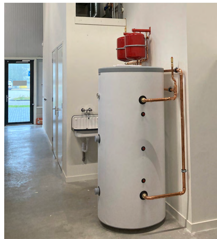
Afb.6. Warmtepomp installatie in bedrijfshal
