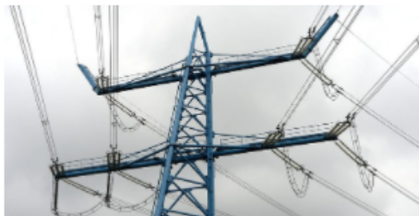
Een concordiemast van TenneT. Beeld ANP
